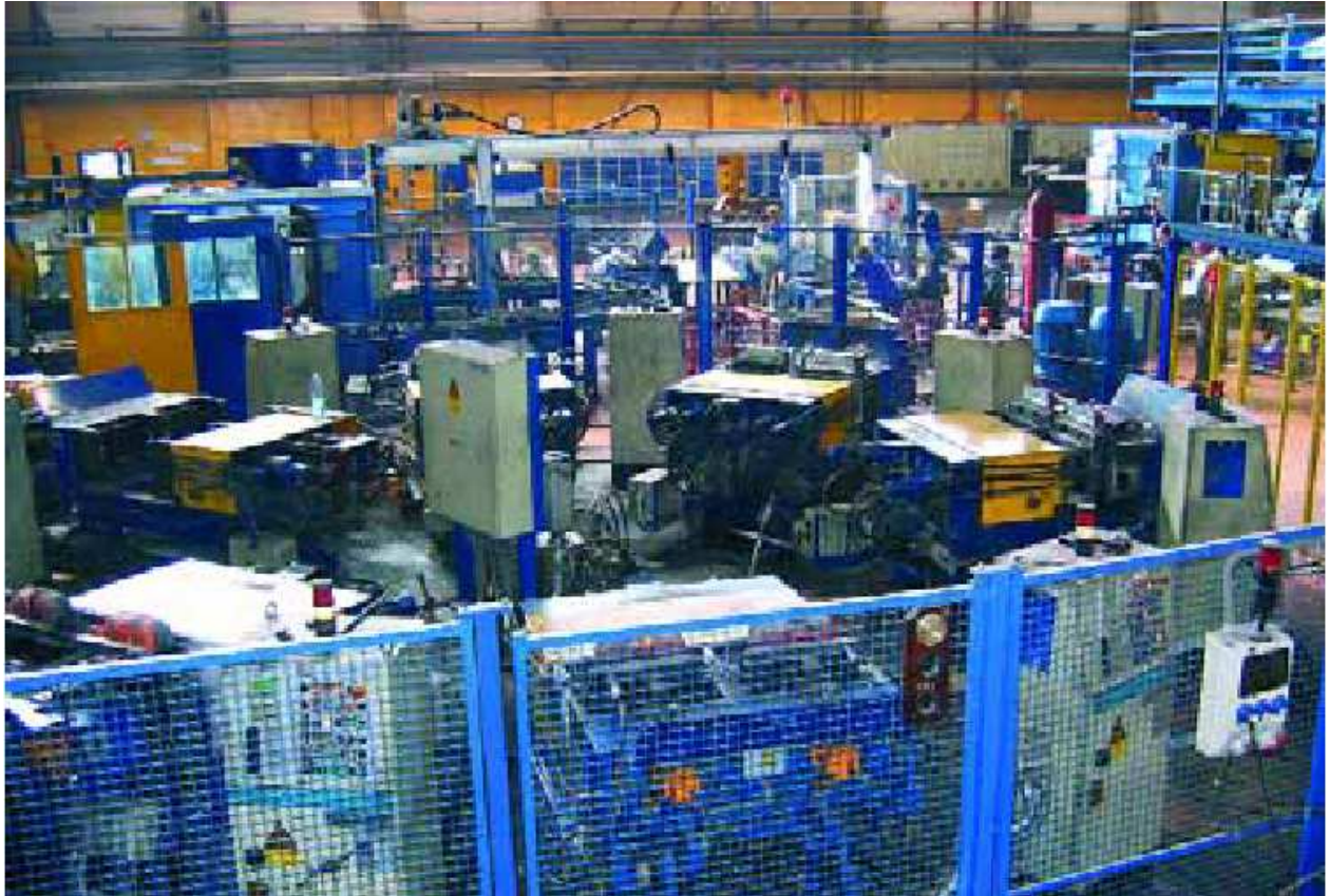
7. Gniazdo kokilarek karuzelowych z automatycznym zalewaniem form. Eliminacja konieczności stałego przebywania pracownika.
